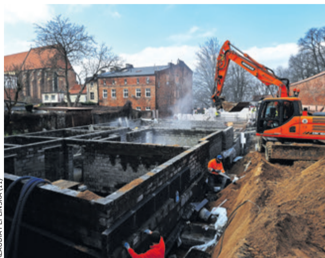
Przy ul. Rycerskiej wystartowała budowa 44 mieszkań komunalnych, na którą pozyskaliśmy ponad 12 mln zł środków zewnętrznych
